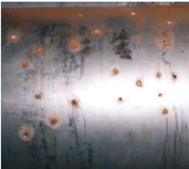
Punkttering af røgrør monteret på korn-fyringsanlæg. Ofte bliver aftræks-systemet stærkt beskadiget allerede efter få måneders drift.
